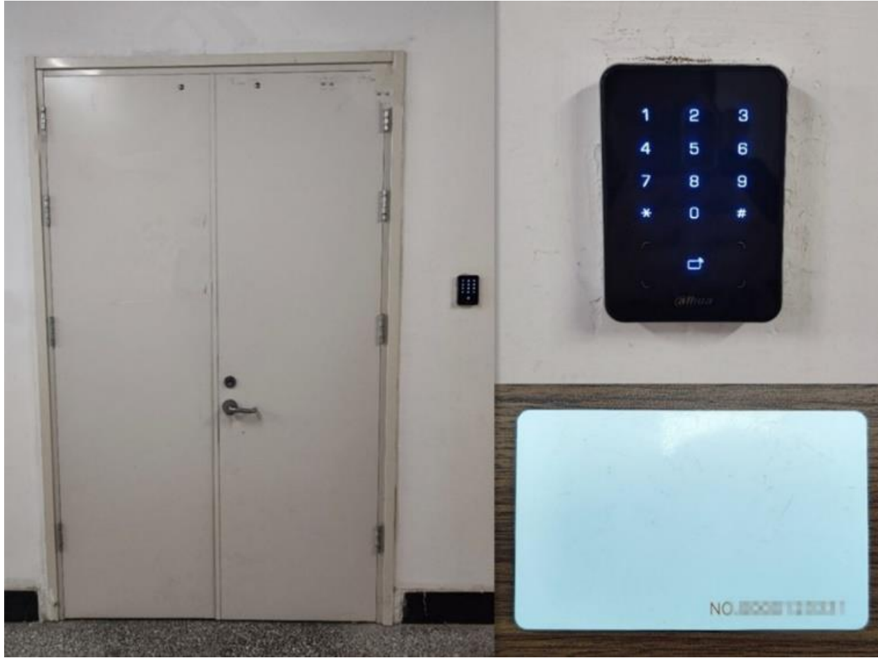
图 C.1- 3 机房安全门禁系统部署实景
